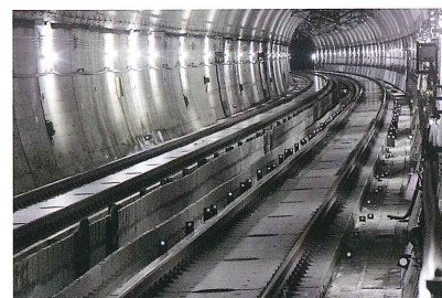
トンネル内の軌道計測事例
